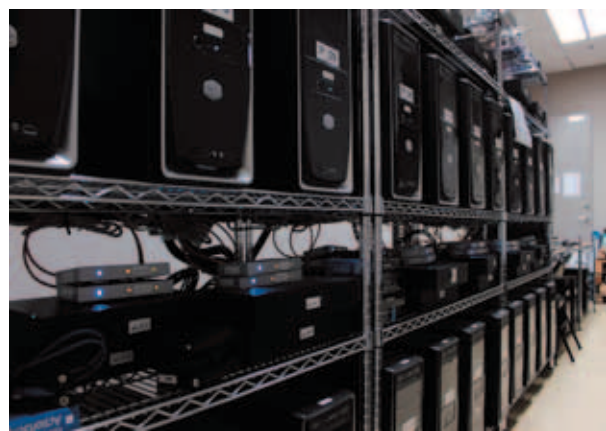
圖八 架設於展場後方之臨時機房，一共架設38台電腦
